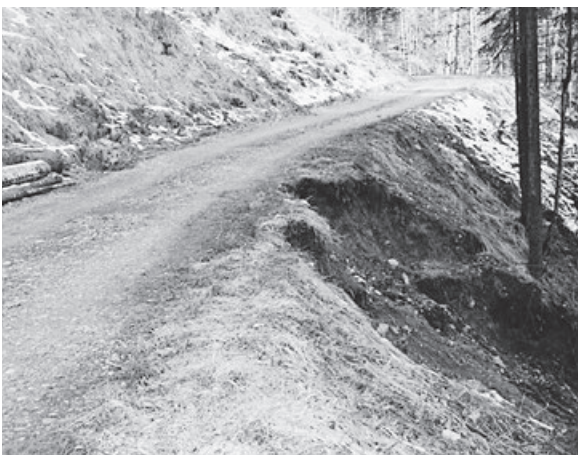
Umghitenstrasse Talseitig abgerutschte Strassenböschung
