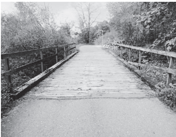
Bärfallenstrasse Brücke vor der Sanierung
