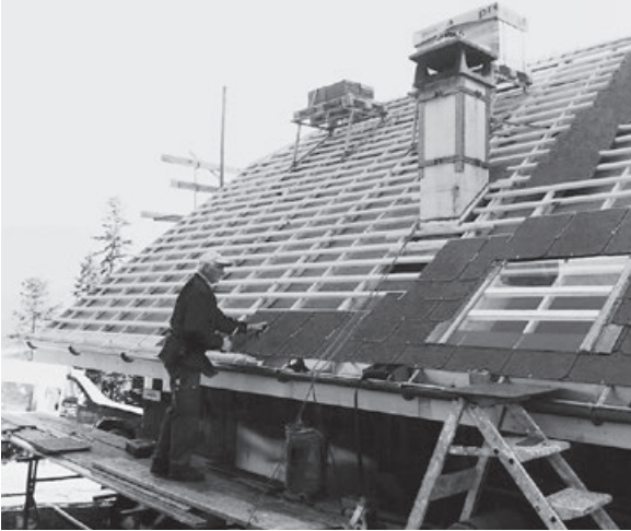
Das Dach ist bereit zum Neueindecken. Auch hier Godi von Ah «am Wärchä».
