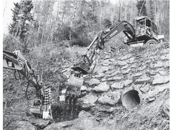
Bärfallenstrasse Sohlensicherung für die talseitige Stützmauer bei der Furt mit Wuhrsteinen in Beton
